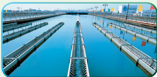
華衍水務的污水處理設施。
